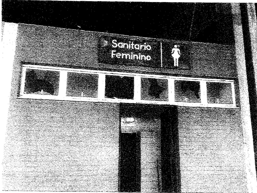
ESQUADRIAS COM VIDROS QUEBRADOS.
